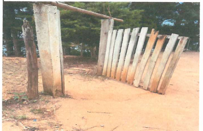
Foto 2: NECESIDAD DE LA CONTRUCCIÓN DEL PORTÓN DE LA ENTRADA DE LA ESCUELA DEL CASERÍO EL AGUACATE, PARA LA SEGURIDAD DE LOS NIÑOS Y NIÑAS QUE ESTUDIAN EN DICHO CENTRO EDUCATIVO. EL PORTÓN ESTÁ DETERIORADO Y CON Poca SEGURIDAD PARA EL BIENESTAR DE LOS NIÑOS.
